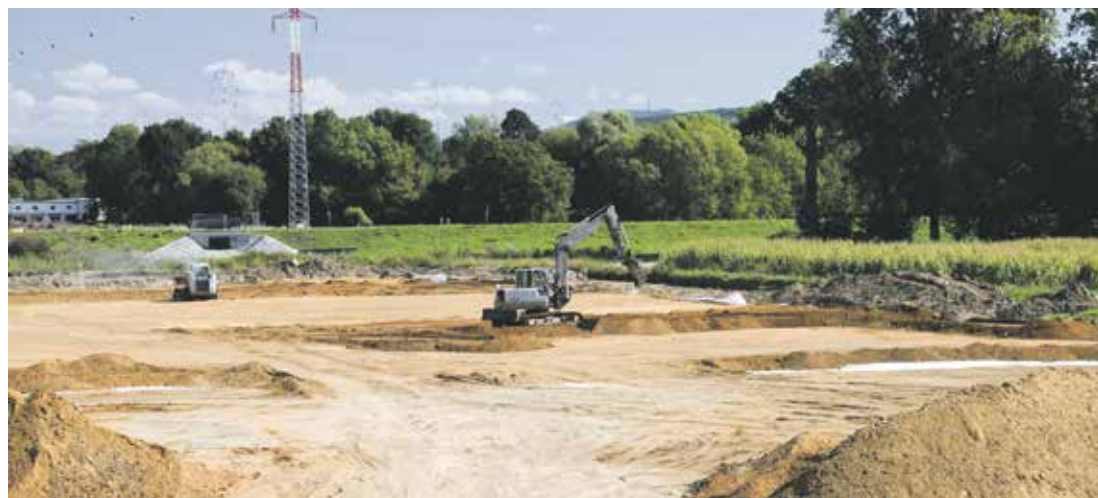
Nový most by měl být hotov do konce příštího roku. Foto | Ředitelství silnic a dálnic ČR
