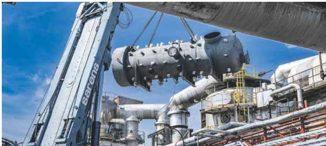
Nový výměník patřil k nejmohutnějším zařízením, která se v rámci modernizace ve Spolaně instalují. Foto | Spolana Neratovice
