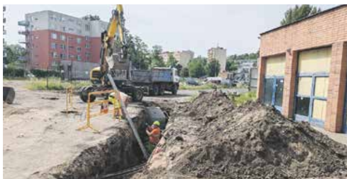
Zimní stadion se zbavil odpadních jímek a je posledním městským objektem, který se napojil na veřejnou kanalizaci. Foto | město Mělník
