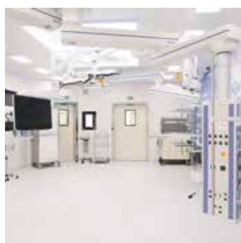
Nové operační sály jsou vybaveny nejmodernější technikou. Foto | Nemocnice České Budějovice
