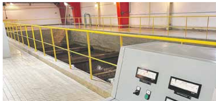
Úprava vody v Milencích byla dokončena v roce 1986, obnovu potřebuje. Foto | město Klatovy
