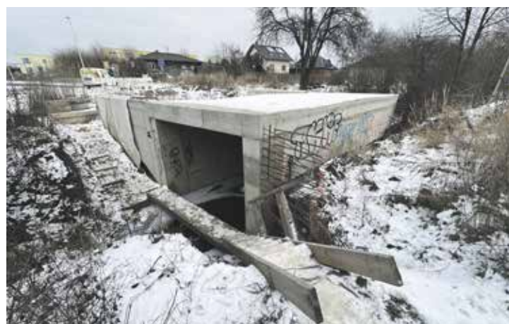
Uzavření mostu komplikuje už delší dobu dopravní spojení ve Víně a Přezleticích. Foto | MČ Víně
